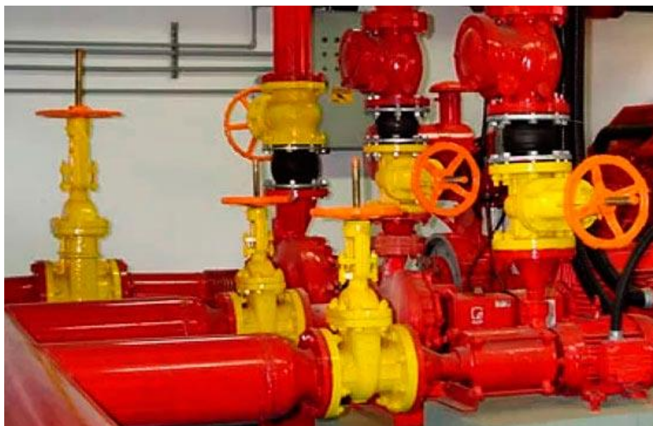
Figura 42 – Bomba de incêndio e acessórios hidráulicos
