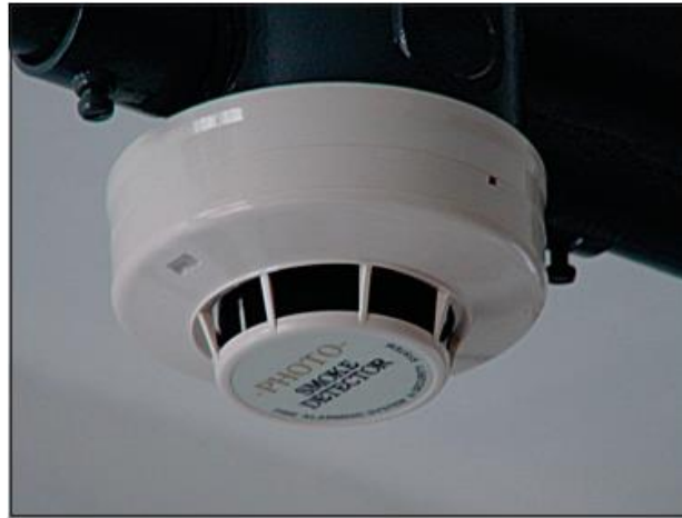
Figura 33 – Detector de incêndio
