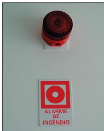
Figura 35 – Detalhe da sirene
