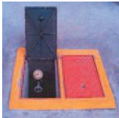
Figura 40 – Registro de recalque para bombeiros
