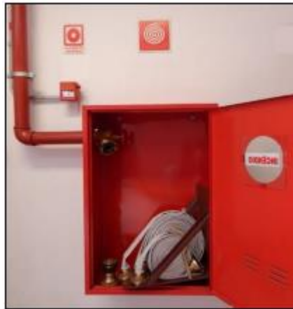
Figura 39 – Detalhe de hidrante
