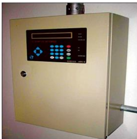
Figura 36 – Central de alarme
