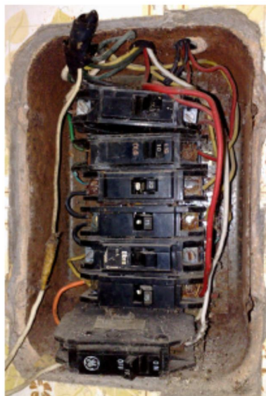
Figura 9 – Quadro de Força e Luz Fonte: CAVALCANTE (2010)
