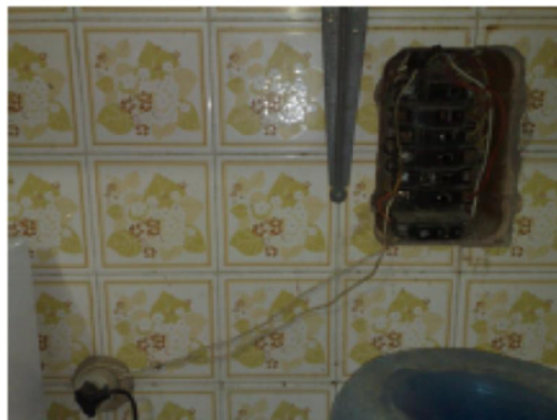
Figura 10 – Tomada da Geladeira Fonte: CAVALCANTE (2010)
