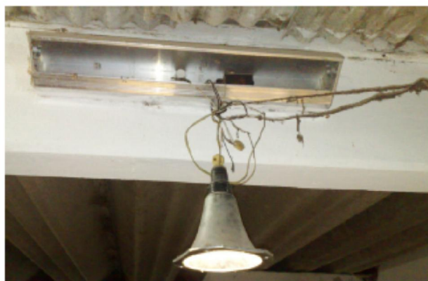
Figura 11 – Luminária Adaptada e Fiação Exposta Fonte: (CAVALCANTE, 2010)
