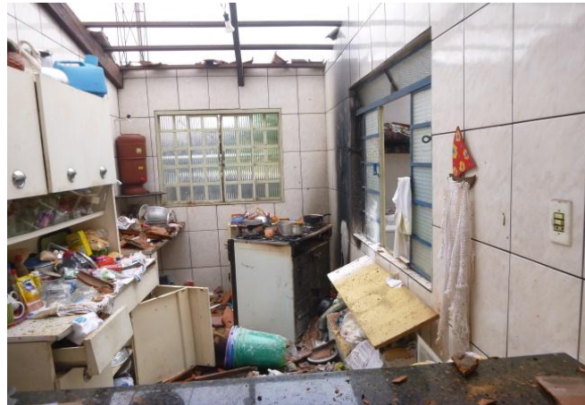
Figura 4 - Explosão causada por vazamento de GLP P-13 Fonte: Cap. Valério
