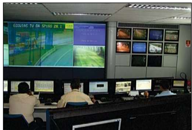
Figura 3 – Central de monitoramento
