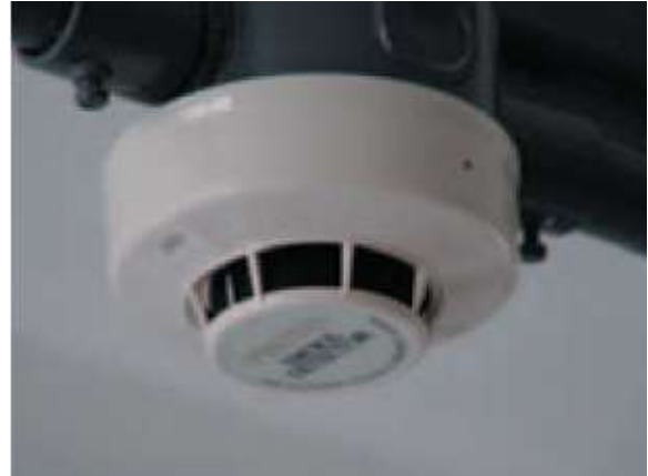
Figura 34 – Detector de incêndio
