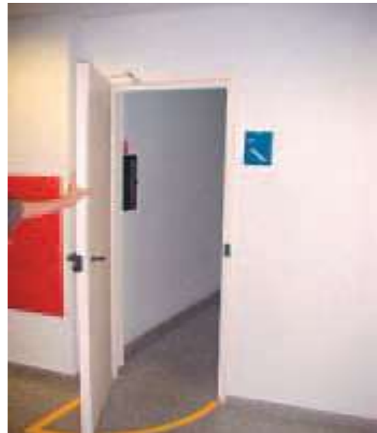
Figura 29 – PCF em corredor
