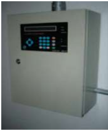
Figura 37 – Central de alarme
