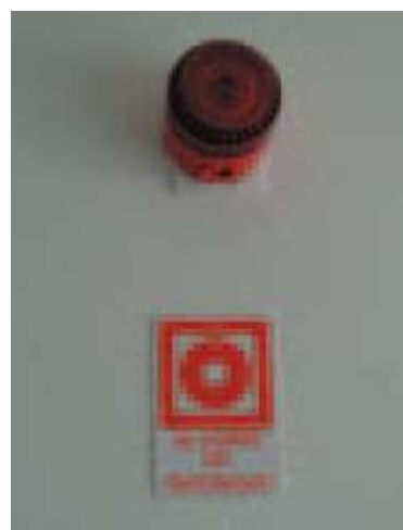
Figura 36 – Detalhe de sirene
