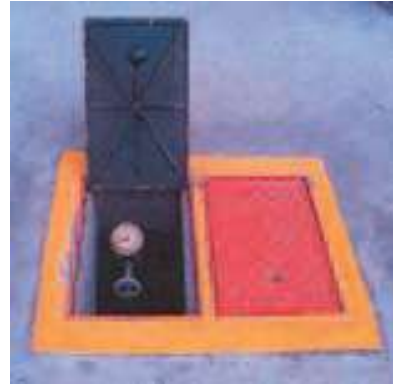
Figura 41 – Registro de recalque para bombeiros
