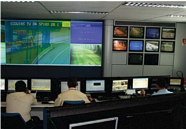
Figura 3: Central de monitoramento
